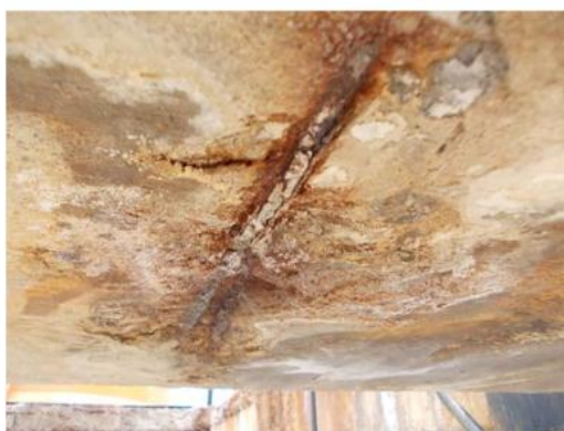
- Concreto apresentando corrosão de armadura.
