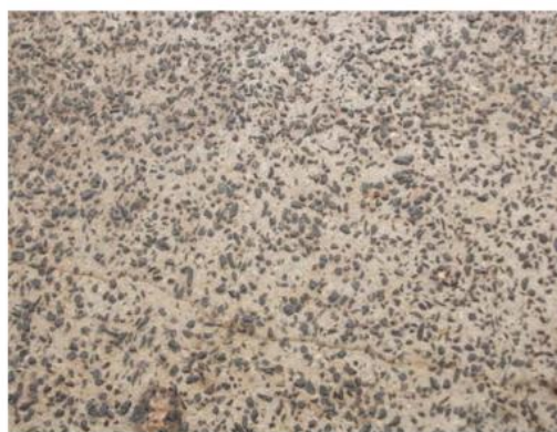
- Concreto danificado por ataque ácido
